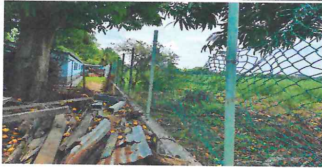
Foto 1: Muro perimetral de la EORM Aldea el Panal, el cual se encuentra en mal estado
